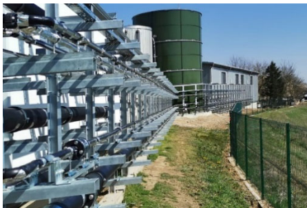
Foto: Abwässer aus der Fruchtverarbeitung werden zuverlässig auf die geforderten Grenzwerte gereinigt.
