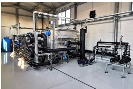
Foto: Eine Flomar Flotationsanlage ist die Hauptkomponente der Abwasserbehandlung.
