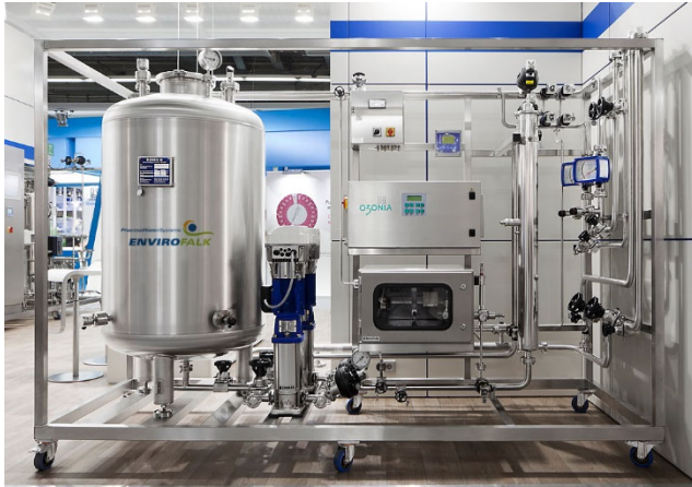
Bild: PW-Lager- und Verteilsystem mit Ozonisierung für ein Logistikzentrum und die Klinikapotheke der RKH Kliniken in Ludwigsburg / Bietigheim
