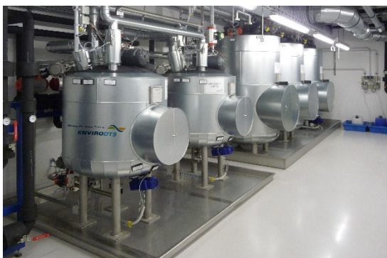
Bild: EnviroDTS thermische Abwasserdesinfektion der S4-Abwässer aus dem Robert Koch Institut in Berlin
