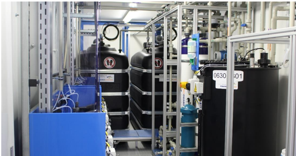
Bild: Anlagenmodule für das Wasserrecycling kompakt im EnviModul eingebaut.
