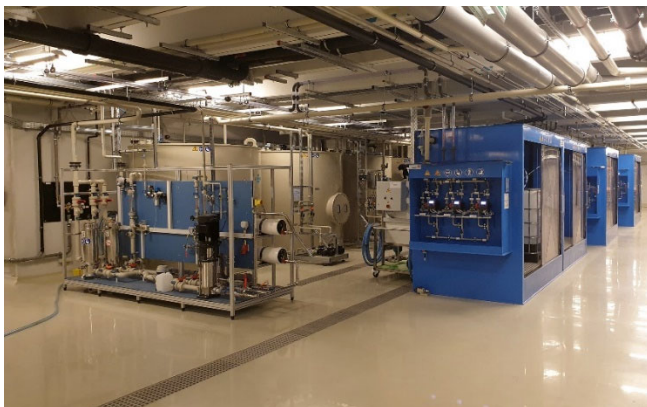
Bild: Anlage zur chemisch-physikalischen Abwasserbehandlung für einen Hersteller von Solarzellen.
