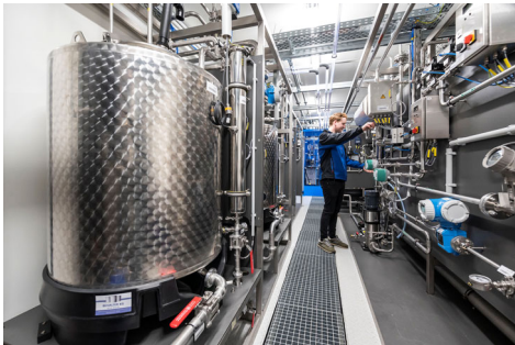
Kompakte Pilotanlage für die Wiederverwendung von Prozesswasser in der Molkereiindustrie.
