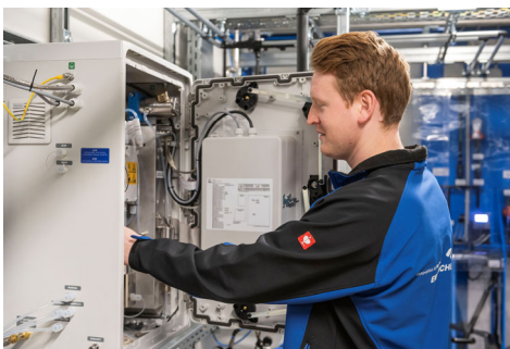
Die Pilotanlage ist mit TOC-Analysegeräten von Hach Lange ausgestattet.
