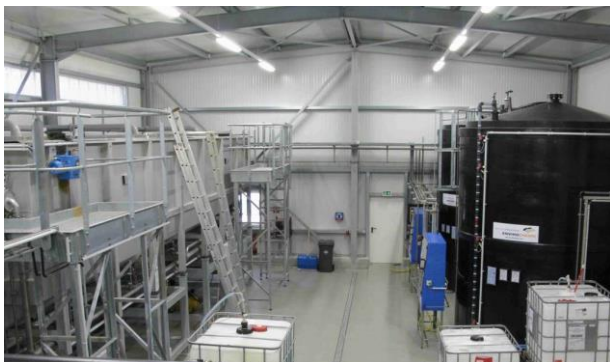
Bild: die neue Abwasservorreinigung senkt die Starkverschmutzergebühren deutlich.
