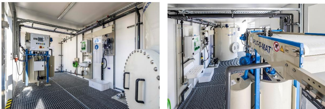
Image : Un aperçu du local technique EnviModul avec l'installation de traitement par lots des eaux usées Split-O-Mat® SOM 500LB.
