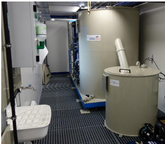
Bild: Blick in den EnviModul Technikraum mit Flotationsanlage Lugan® 10.000 zur Abwasserbehandlung.
