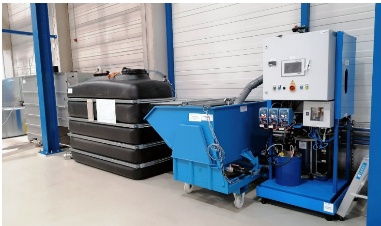
Bild: Lugan Anlage mit Schlamm-Kippcontainer, Stapeltank und Hochleistungsabscheider zur Behandlung von Abwässern aus Reinigungsprozessen der Werkstätten.
