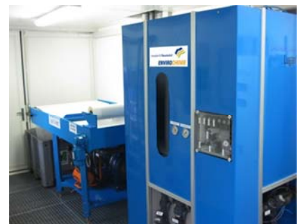
Innenansicht einer Lugan Flotationsanlage im Technikmodul
