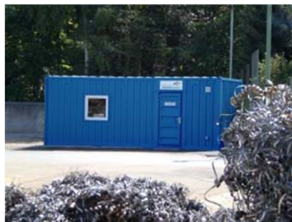
Kompakte Lugan Flotationsanlage im Technikmodul zur Behandlung des Abwassers von Spänelagern
