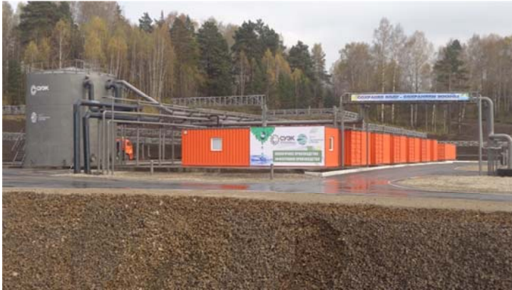
Bild: Innovative Wasseraufbereitungsanlage für das Kohleunternehmen SUEK-Kuzbass
