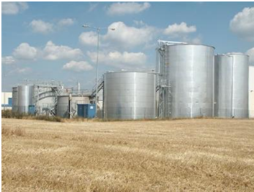
Außenansicht der Anlage
