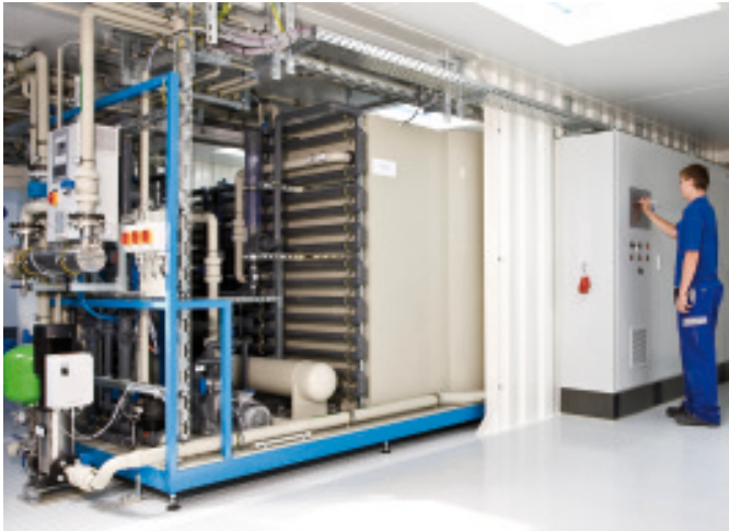
Innenansicht einer Envimodul-Abwasservorbehandlungsanlage
