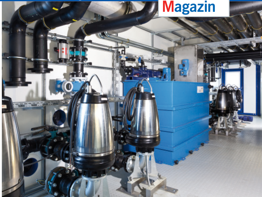
Blick in eine Envimodul-Abwasserbehandlungsanlage
