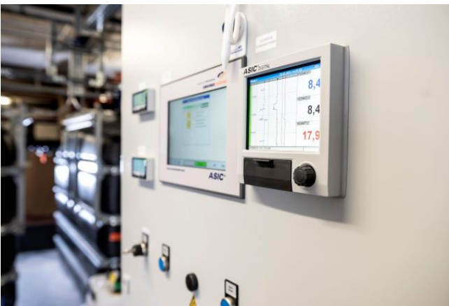
Über das Touchpanel wird die komplette Kompaktanlage gesteuert
